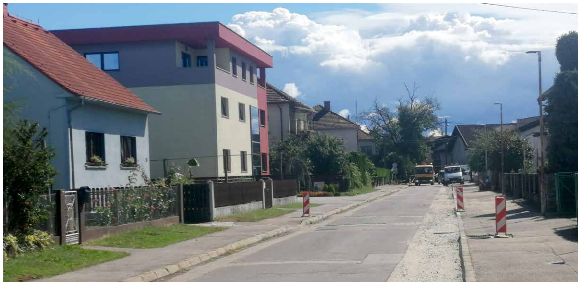
Tudi Aškerčevo ulica bo deležna sanacije.
