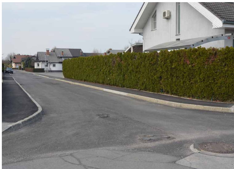
V novem delu Černelavcev so prebivalci že več let ob obilnih padavinah imeli težave z odvodnjavanjem in poplavljanjem kletnih prostorov, zato je Mestna občina Murska Sobota že pred petimi leti prvič začela s sanacijo kanalizacijskega omrežja.
