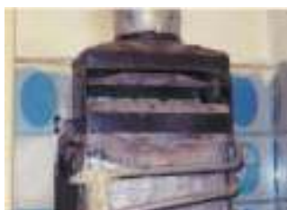
Nevarnost: Zelo umazan/zasajen plinski kotel
