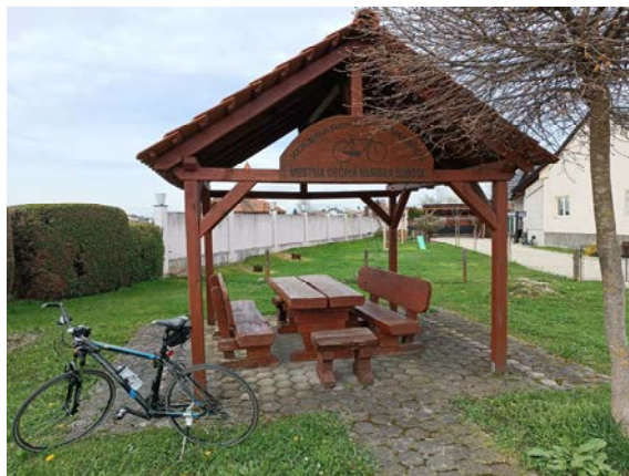
Slika 27 ; Kolesarsko postajališče z dotrajano in odtujeno opremo (na sliki kolesarsko postajališče v naselju Černelavci).
